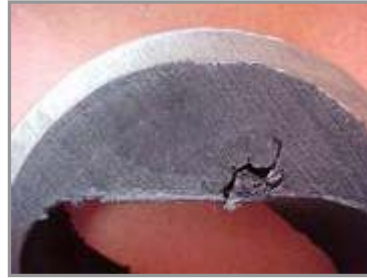
2- Comienzo del desprendimiento del elastómero, debido a la rigidez del mismo
